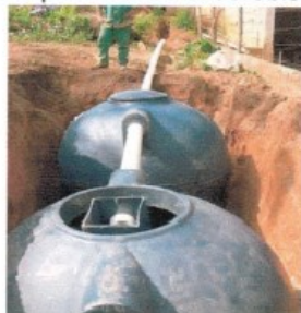
Tanque séptico e filtro anaeróbio (PEAD)
